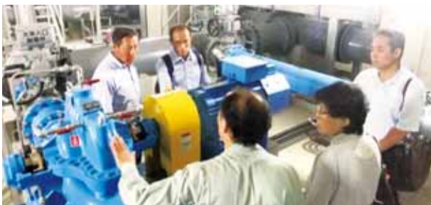
久御山ポンプ場地下発電機
